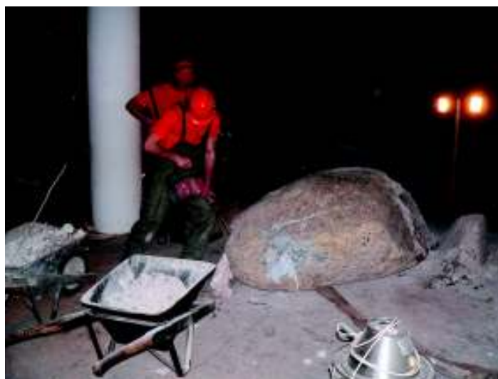
Une ambiance de mine... quand les hommes de la PC ont attaqué le bloc erratique: il a fallu 3 jours au marteau piqueur et l'utilisation de «dynamite douce» pour réussir à diviser le bloc erratique, posé avec la grue de chantier avant le coulage de la dalle du rez-de-chaussée en 1976. Les morceaux ont été extraits du Musée afin de permettre le passage à cet endroit.
